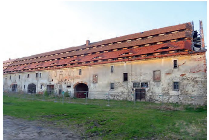
Ein Bild aus dem Jahr 2018 macht den zunehmenden Verfall deutlich. Der Ostgiebel ist durch Einregentellen im Dach stark beschädigt.
