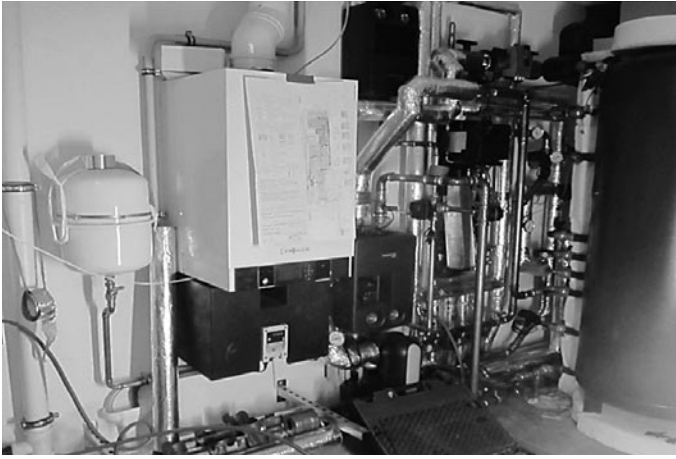
Installationen im Technikraum
